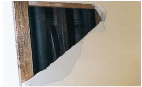
Bwrdd ynysu asbestos (AIB)
