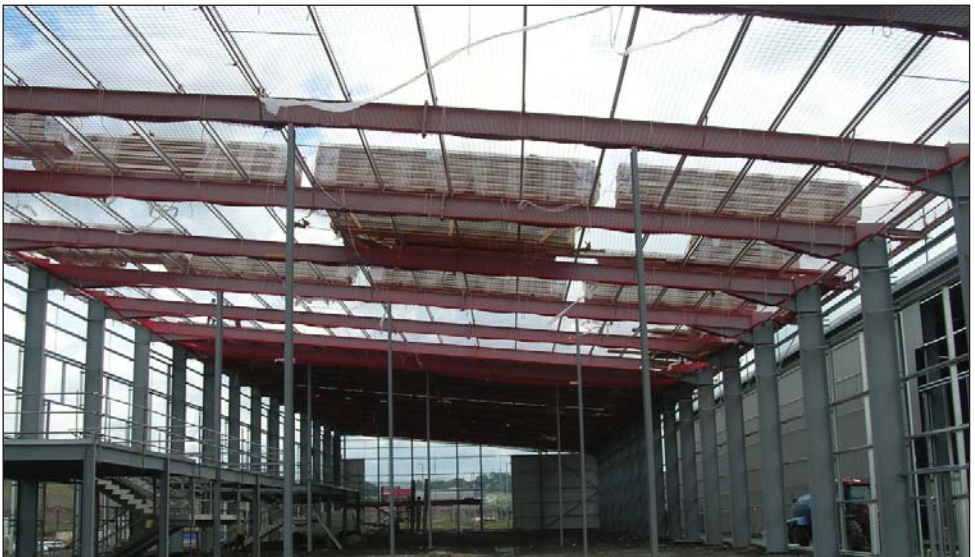
Figura 7 Plase de protecție montate înainte de poziționarea foilor de tablă. Plasa se fixează dedesubtul acoperișului, cât mai aproape posibil, pentru a se reduce distanța de cădere
