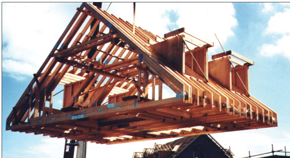
Ilustracja 6. Zmontowanie kratownicy dachowej na ziemi, a następnie umieszczenie jej za pomocą dźwigu eliminuje konieczność prowadzenia prac na wysokości
